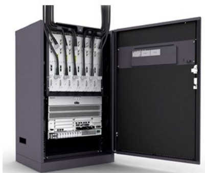
モバイル基地局の設備
